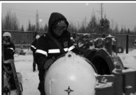
Камера пуска-приёма очистных устройств на стратегическом для стражевчан газопроводе
